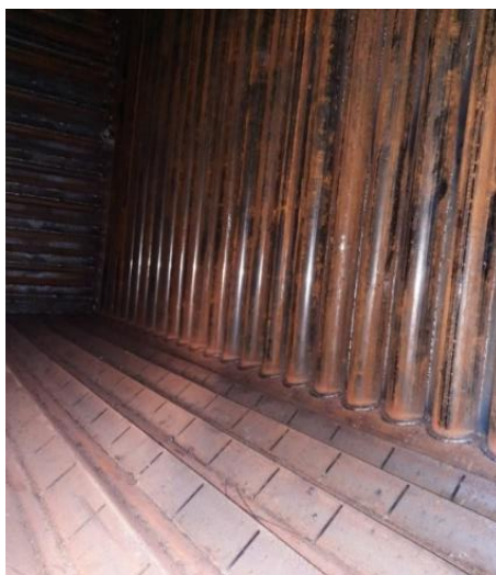
Рисунок 2 - Вид топочной камеры котельного агрегата КВр-1,16
