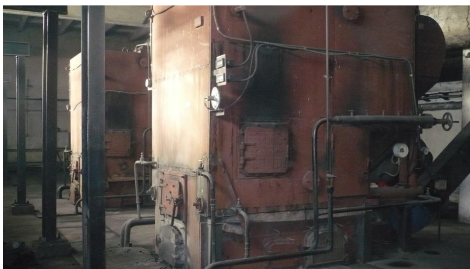
Рисунок 1 - Котельные агрегаты КВ-1.8/1.5 БиКЗ отопительной котельной ГУЗ Ононская ЦРБ
