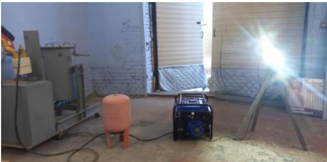
Рисунок 1 – Общий вид автономной электрической станции: 1 – установка ГВА-1; 2- газовый счетчик; 3 – газгольдер – компрессор; 4 – газовый генератор; 5 - лампа
